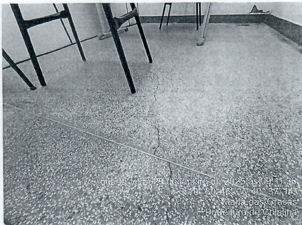
Figura 08 – Vista da trinca no piso causado pelo recalque em área interna.
