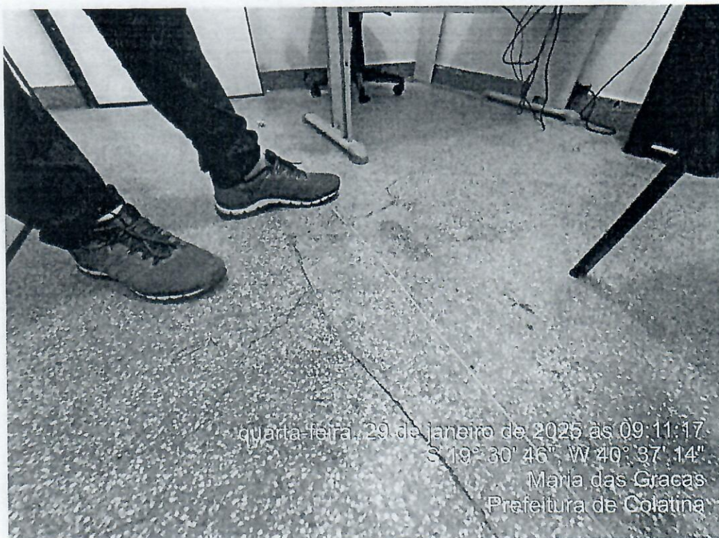
Figura 07 – Vista da trinca no piso causado pelo recalque em área interna.
