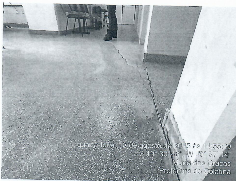
Figura 5: Vista de trinca identificada em piso, já registrada em relatórios anteriores
