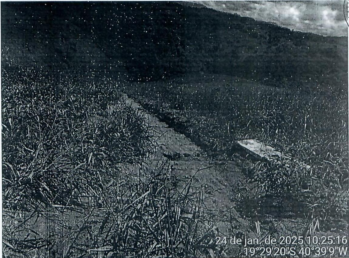
FOTO 7 – PONTO DA DRENAGEM PREVISTA EM PROJETO
