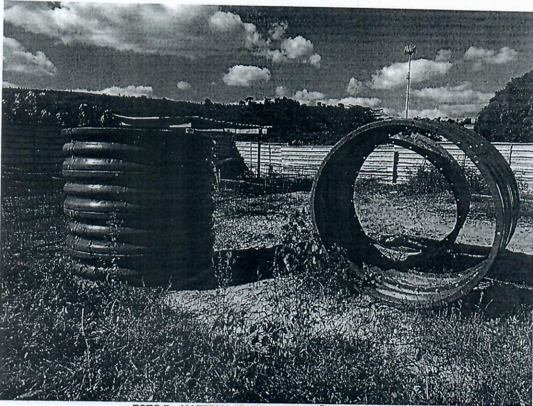
FOTO 7 – MATERIAL TUNNEL LINER NÃO EXECUTADO
