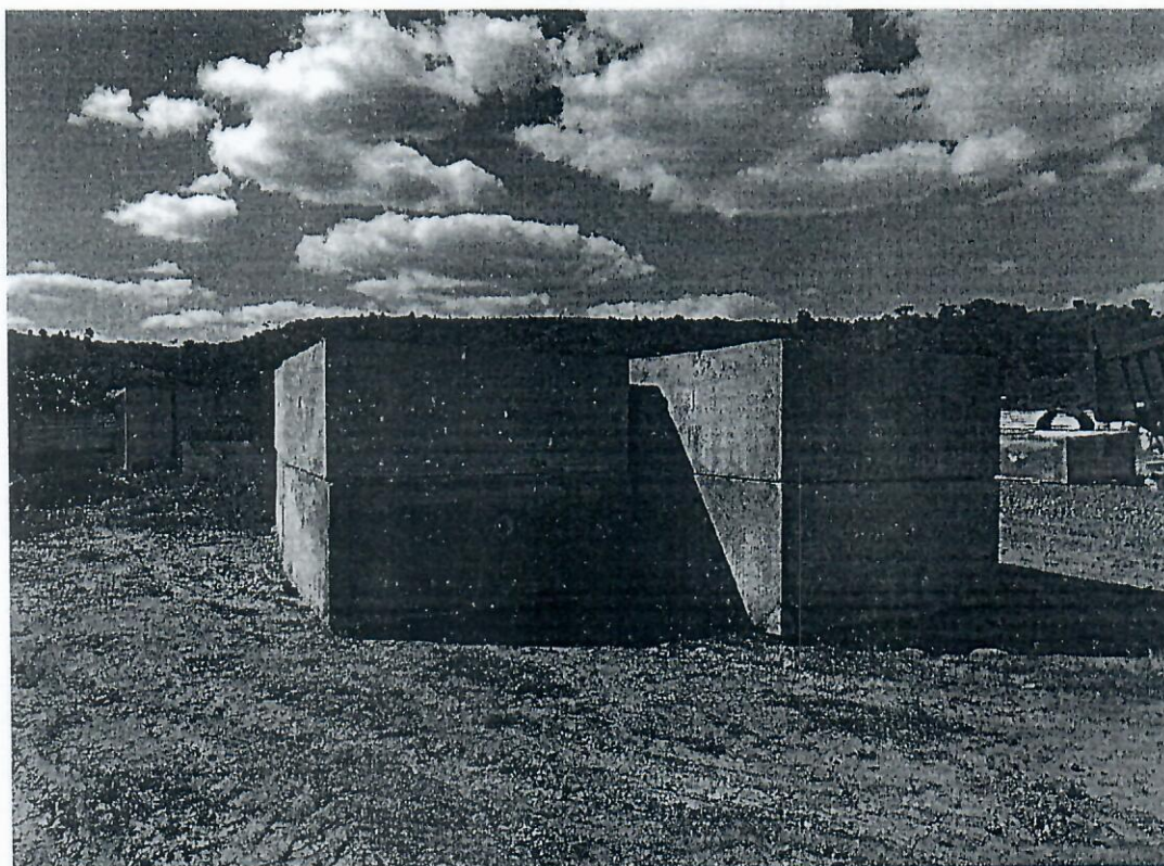
FOTO 4 – GALERIA DE CONCRETO CELULAR NÃO EXECUTADO
