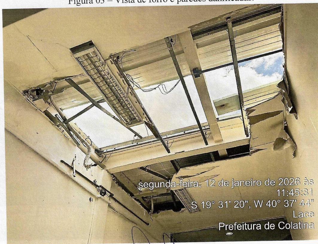
Figura 04 – Vista interna de forro e cobertura danificados.
