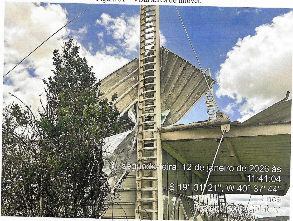
Figura 02 – Vista do telhado danificado.
