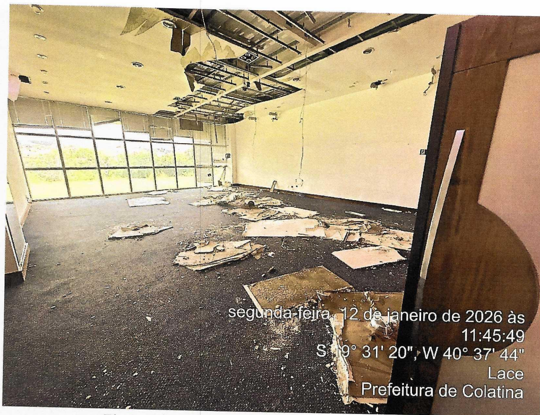
Figura 05 – Vista deslocamento de forro de gesso.
