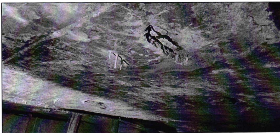
Figura 3 - Formação de estalactites / deslocamento de concreto, consequência do microfissuramento e presença de água, comprometendo a sanidade do concreto.
